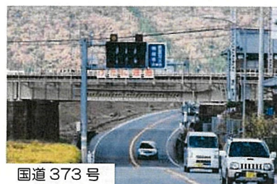
国道373号 道路アンダーパスの冠水表示板
