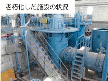
老朽化した施設の状況 2号ポンプ設備 (12年経過)
