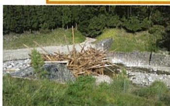
写真⑧ 土砂・立木の捕捉状況 (宍粟市 谷川砂防えん堤)
