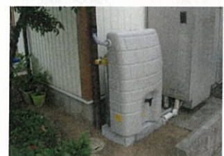
写真⑥ 各戸貯留施設の事例 (たつの市)
