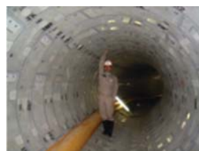
雨水貯留管 （左：西宮市 上：伊丹市）
