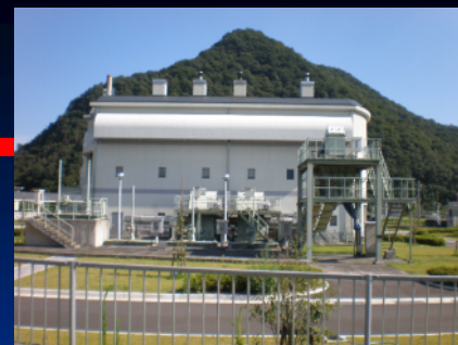
ポンプ施設の例(駅前雨水ポンプ場：上郡町)
