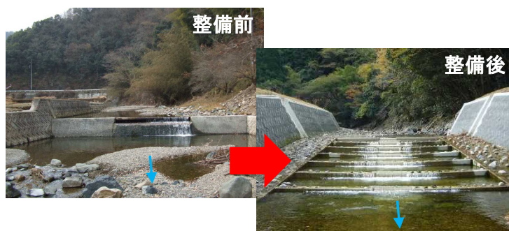
大日山川・八日市井堰(佐用町)【災害関連事業】 階段式魚道
