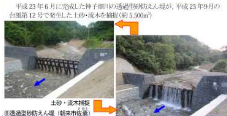
【朝来市の神子畑川における砂防えん堤による土砂の捕捉状況（平成23年台風12号）】
