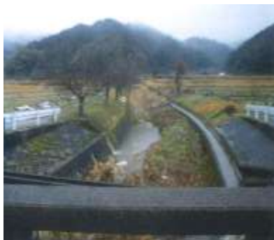
堆積土砂撤去前（日高町）
