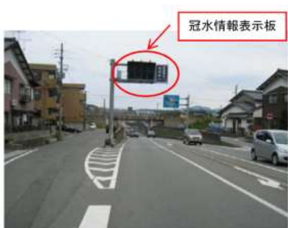
【冠水情報板（豊岡市国道178号 中陰架道橋 JR山陰本線アンダーパス）】
