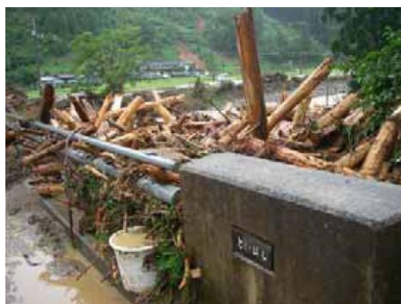
流木による橋梁箇所での閉塞状況
