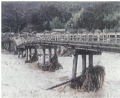
香住町（当時）大野の大野橋の被災状況
