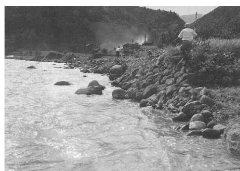
関宮町（当時）の八木川の流失した護岸
