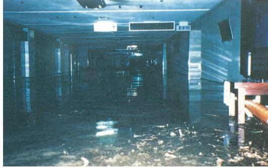
浜坂町（当時）の岸田川流域内にある公立浜坂病院の浸水状況
