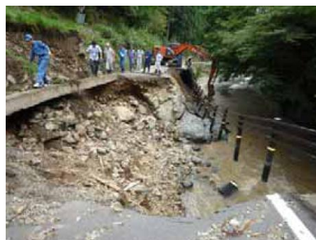
護岸崩壊による道路崩落箇所
