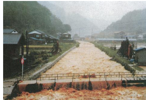
香住町(当時)餘部の橋梁を越流する西川の増水状況
