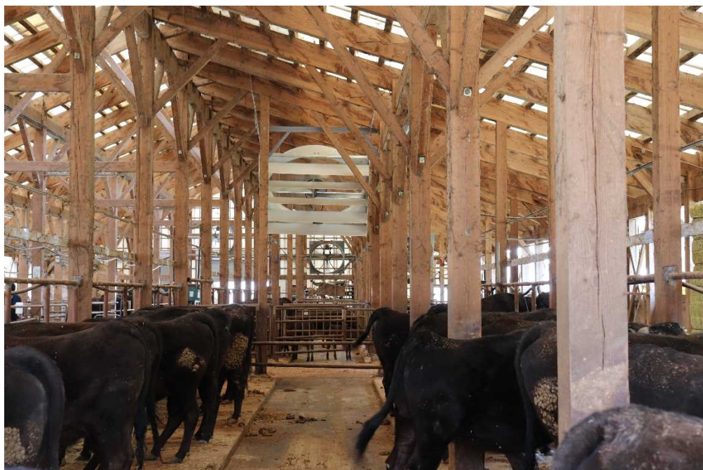
写真3 サイクロン型ファンの設置の状況
