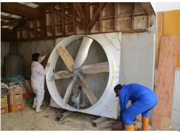
写真2 サイクロン型ファンの羽根径は183cm(整流板取り付け前)
