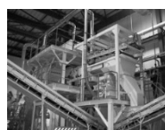
近畿工業(株) 小型家電・基板リサイクルプラント
