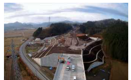
北近畿豊岡自動車道 日高豊岡南道路 (仮称) 日高北IC付近（豊岡市）
