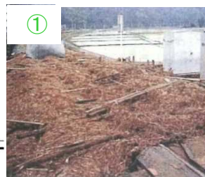
H16.10被災状況
