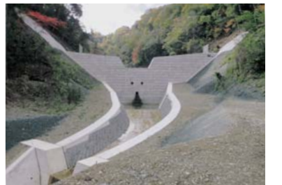
平成21年台風9号災害 長ヶ谷川砂防えん堤(佐用町)
