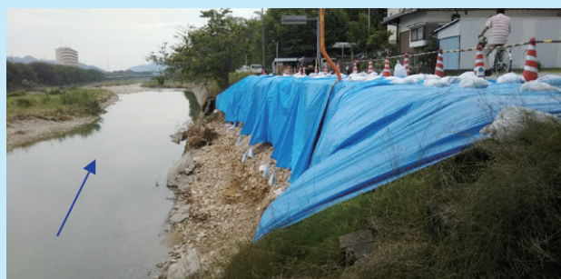
(二) 夢前川の護岸崩壊 (姫路市書写)
