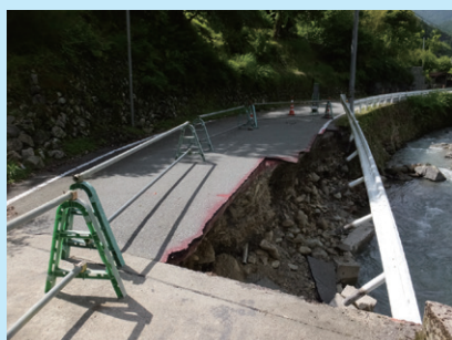
(主) 姫路神河線の路肩崩壊 (姫路市夢前町山之内)
