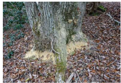
根元に堆積したフラス
