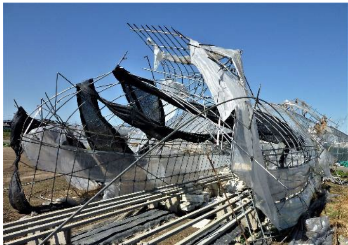
台風被害の様子
