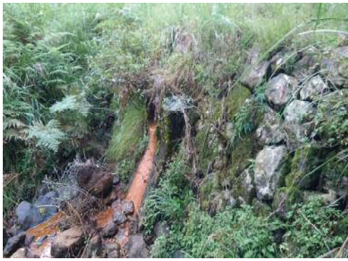
老朽化で取水、放流ができなくなった樋
