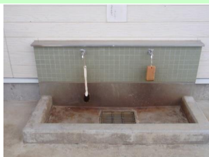
手洗いや農機具洗浄のための給水施設
