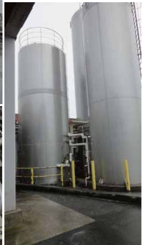
<写真右下> 生乳を貯蔵する貯乳タンク
