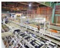
兵庫木材センター製材ライン (宍粟市一宮町)
