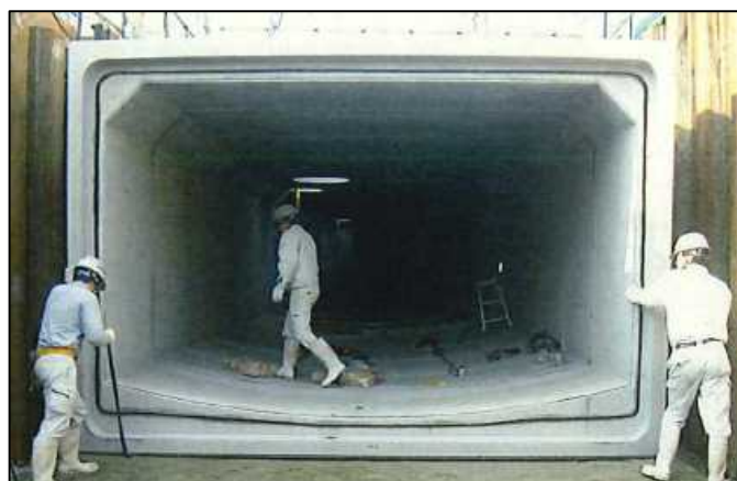
貯留槽（加古川市）
