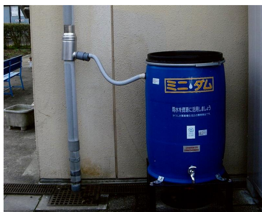
雨水貯留タンク
