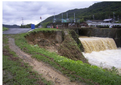
菖蒲池下流の出水状況
