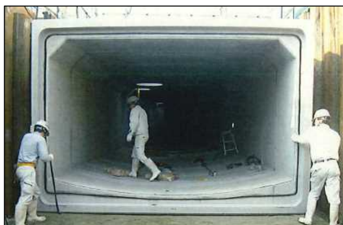
貯留槽（加古川市）
