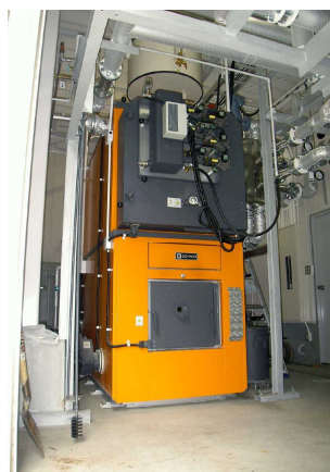
木質バイオマスチップボイラー
