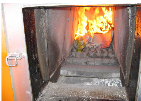
(ボイラー内部)
