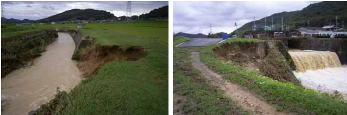
菖蒲池下流の出水状況写真
