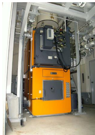
木質バイオマスチップボイラー
