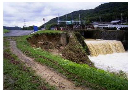
菖蒲池下流の出水状況
