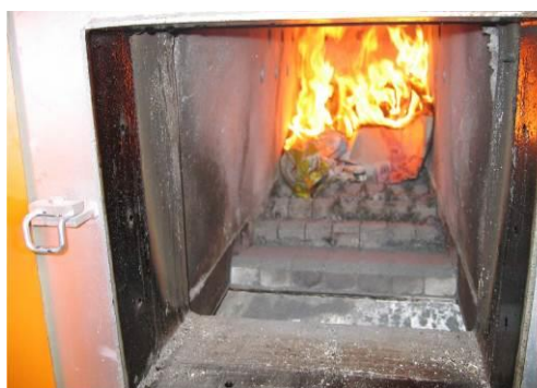
(ボイラー内部)
