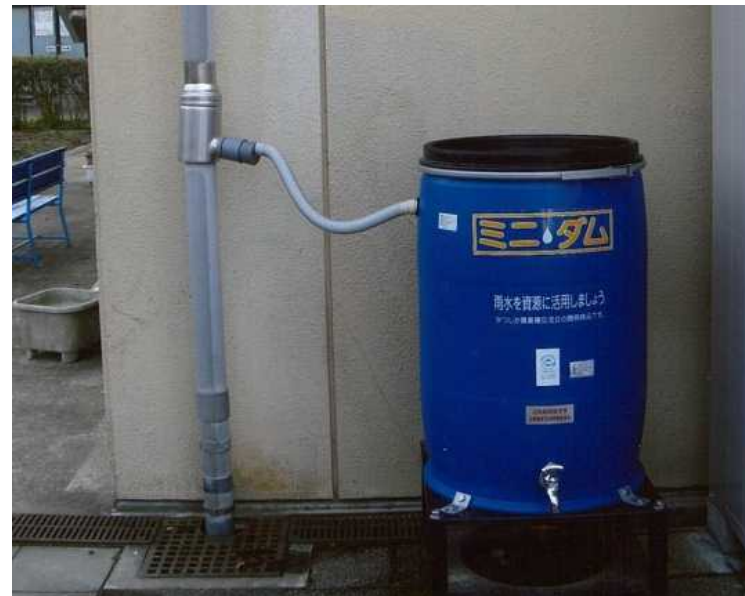
各戸貯留(雨水タンク)
