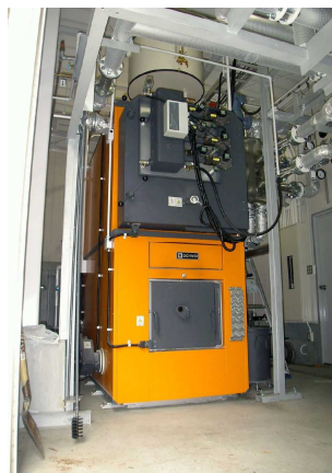
木質バイオマスチップボイラー
