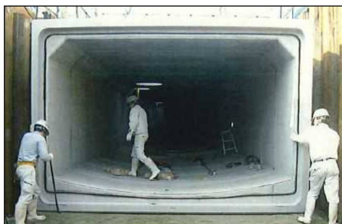
貯留槽（加古川市）
