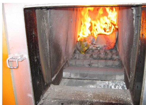
(ボイラー内部)
