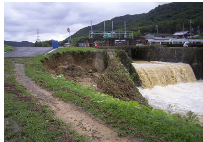
菖蒲池下流の出水状況
