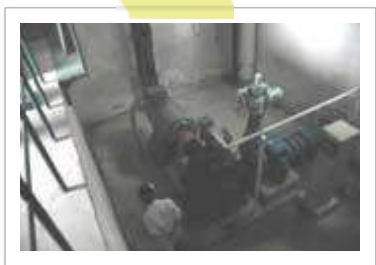
草加野万勝寺地区のポンプは、56mの高さまで上げる巨大なものです
