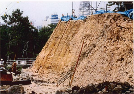
→写真2-1-4 石垣2-11解体完了状況 背面の土層は崩壊しなかつた南方は地山で、崩壊部分から北方は一部が盛土層。崩壊部分は両土層の界面。
