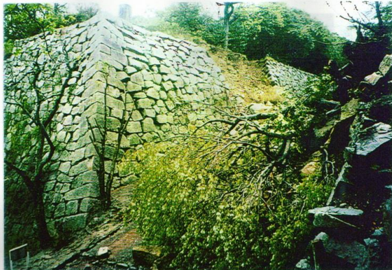
東の丸東側 被災状況
