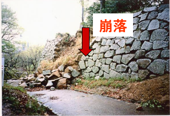
←写真2-1-1 石垣2-11被災状況 崩壊部分は震災以前から孕があった部分、石材は全て花崗岩、玉石の割材を多用裏込栗石は玉石
