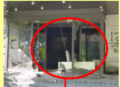
破損 （開口部のガラス割れ）
