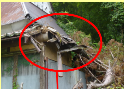
破損 （屋根材の剥落）
