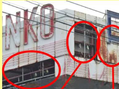
破損 （外装材の剥落） 腐食 （外装材の錆び）
