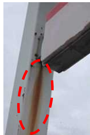
看板本体からポールや壁面への汚ダレは取付部分（ブラケット）の腐食サイン
