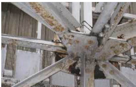
内部鉄骨にサビが見られる屋上広告物
