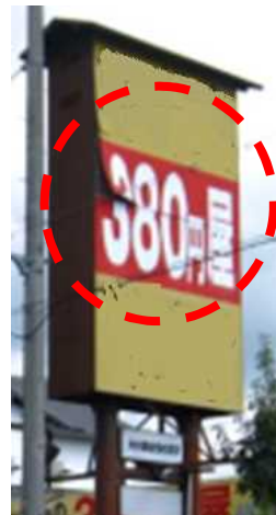
板面（表示面）の剥離が見られる 建植え広告物。
