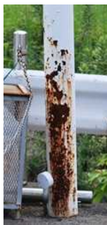
ポールの根元のサビは腐食の恐れも
