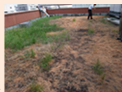
維持管理不足での枯損
