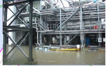
⑨ 浸水被害 (鳴尾浜)
