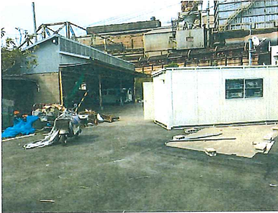
写真1：調査時の堺泉北港湾事務所車庫付近 (右側の白い倉庫が土台から移動)
