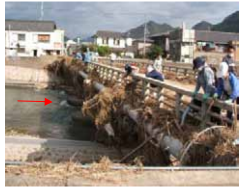
写真 1.2.7 杉原川 西脇市由縁橋被災状況
