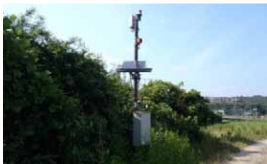
写真 2.3.1 やすらぎの景観警報装置(東条川小野市)
