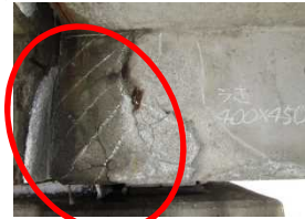
豊国第2橋 上り (主桁コンクリートの 浮き:判定区分Ⅱ)
