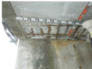
【損傷箇所(研り出し後)】
