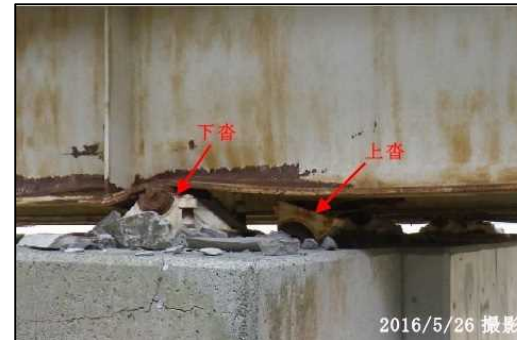
【熊本地震における鋼製支承の破損事例】
