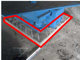
Eランプ橋 (支承モルタルの 浮き:判定区分Ⅱ)
