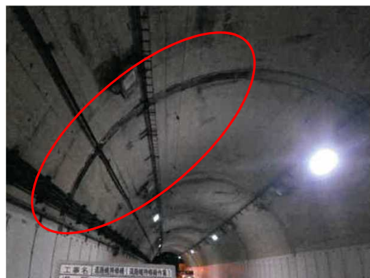
【事例】森垣トンネル
