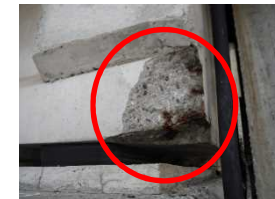
第7高架橋(その3)下り (主桁損傷:判定区分Ⅲ)
