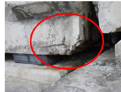
第8高架橋 下り (主桁損傷:判定区分Ⅲ)
