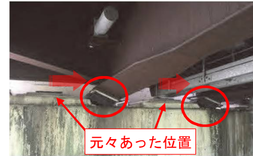
熊本地震における ゴム支承の破損事例
