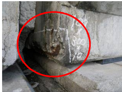
第9-1高架橋 上り (主桁損傷:判定区分Ⅲ)
