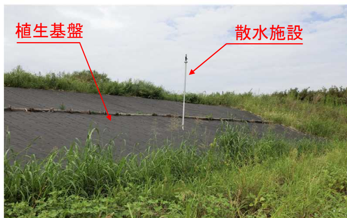
植生基盤・散水施設
