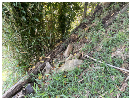
③斜面の荒廃状況
