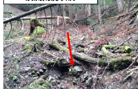
溪流荒廃状況
