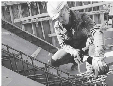
骨格となる鉄筋を確保する折田大稀さん。建物を丈夫にするための重要な仕事だ。
