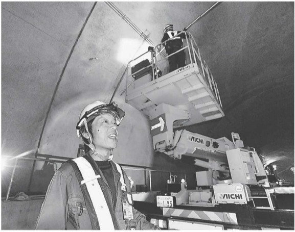
照明設備工事のこだわりを語る宮垣憲次氏。美方郡香美町香住区余部、あまるべトンネル
