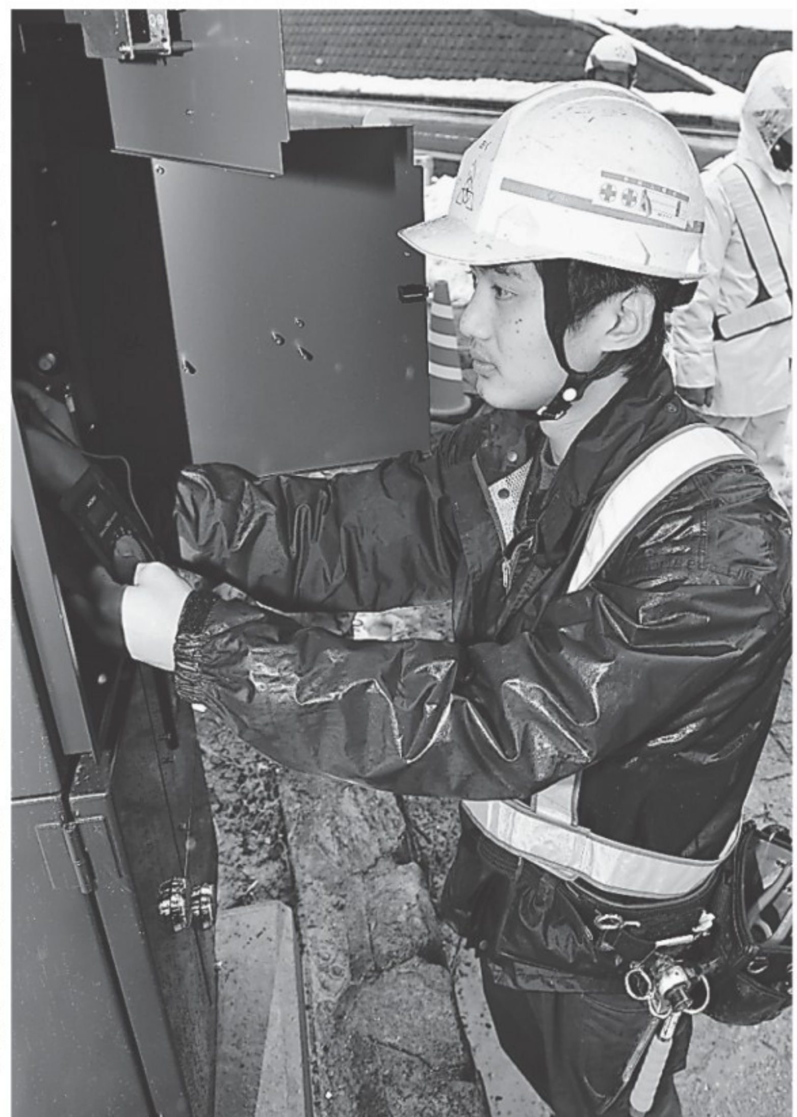
交差点の信号機器の配線工事を行う奥さん。現場は工場、事務所、住宅など多岐にわたる。美方郡新温泉町
