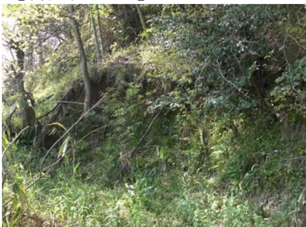
②斜面荒廃状況
