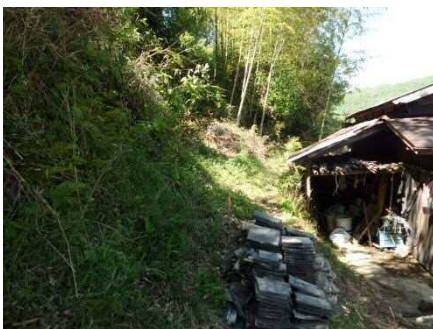
②斜面状況(人家裏)
