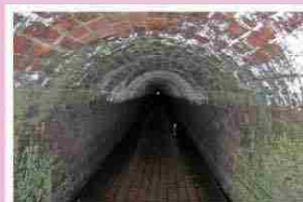
大正3年に造成された水路トンネルの様子 (老朽化が進んでいます)
