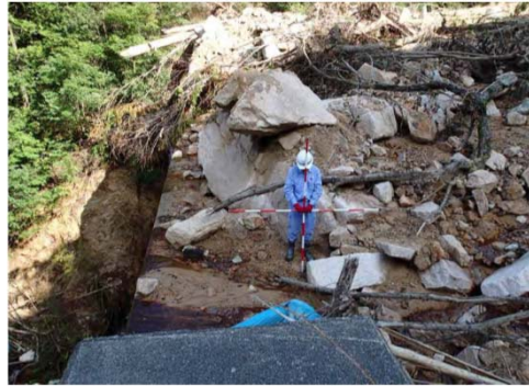
流れてきた大量の土砂や流木などを 食い止めた砂防ダム
