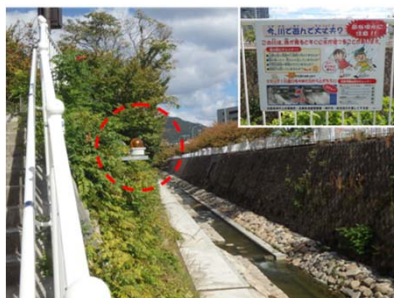
増水警報装置 (妙法寺川)
