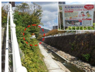
増水警報装置 (妙法寺川)
