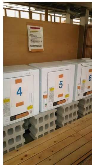
洗濯機・乾燥機・洗濯物干し場
