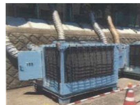
エアコン(室外機)
