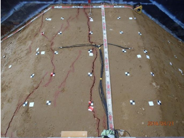
写真 26 シート側天端クラック発生状況
