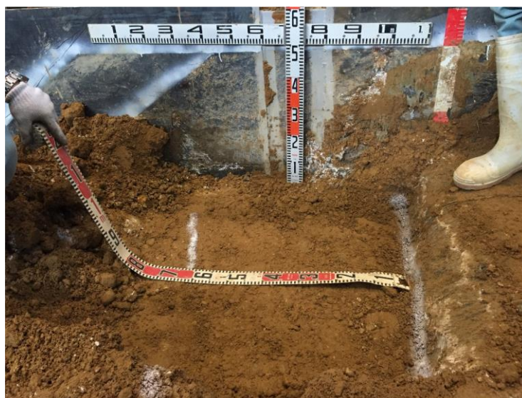
写真 19 発生クラックの掘削調査状況 18)
