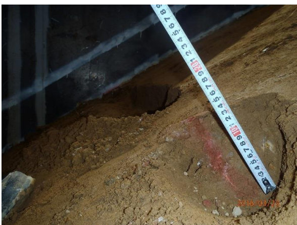
写真 24 前刃金下流法面クラック深さ測定状況
